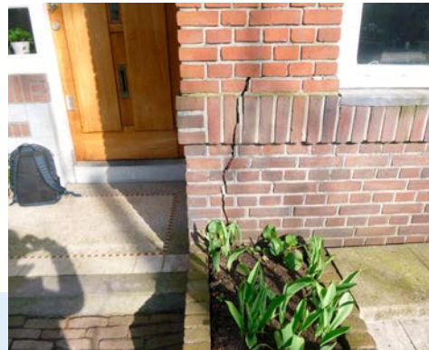
Figuur 20: Gevel met een scheur als gevolg van schade aan de fundering (BVL)
