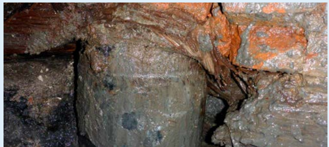
Figuur 45: Houten funderingsconstructie waarbij de paal door het langshout steekt (BVL)
